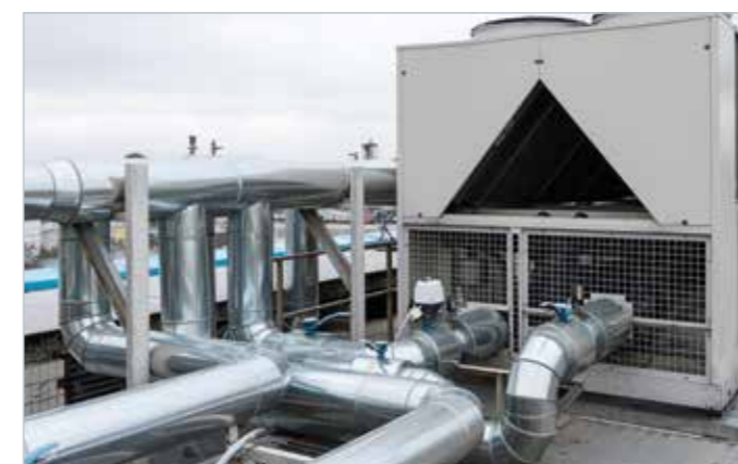
Refroidissement de bâtiments
