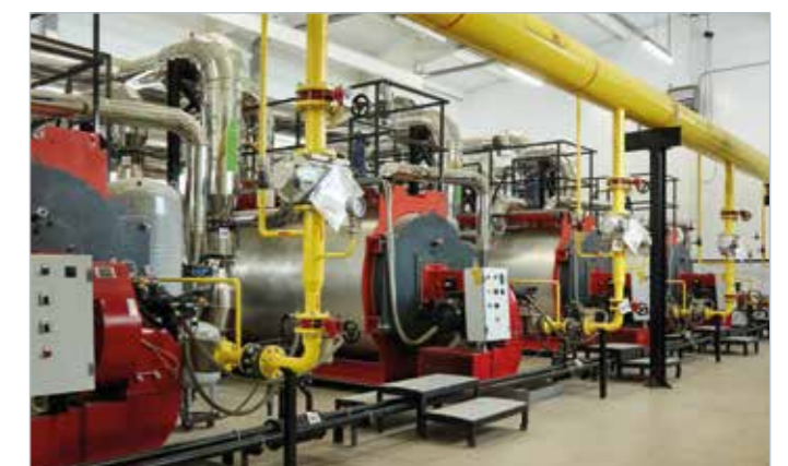
Grosses installations de chauffage
