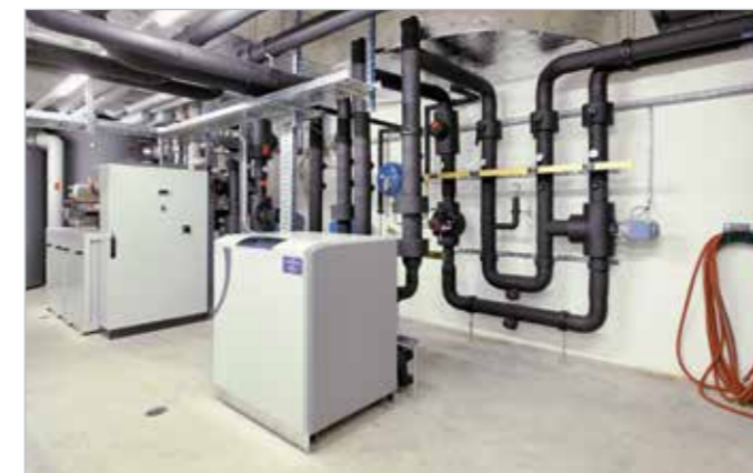
Installations de chauffage
