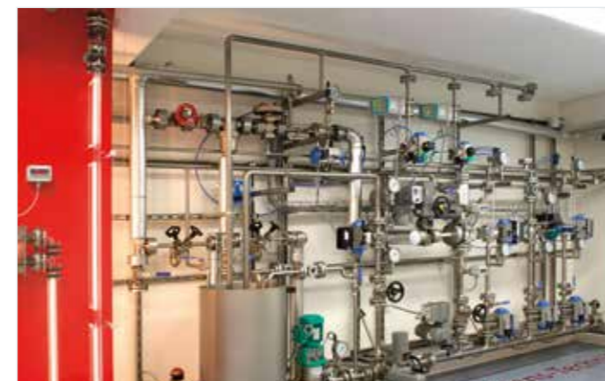
Комплектное промышленное оборудование
