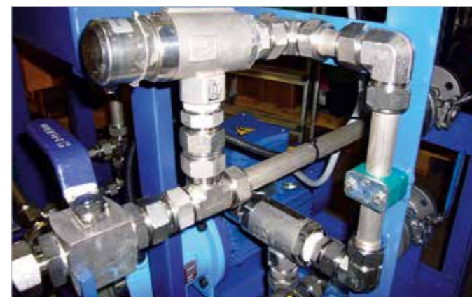
Sistema de combustível
